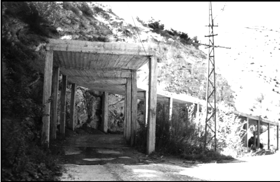
Fotoğraf 5. Tortum Hidroelektrik Santraline ulaşımı sağlayan yol, büyük bölümünde beton karayolu koruma köprüleriyle taş düşmelerinden korunmak istenmiştir.
